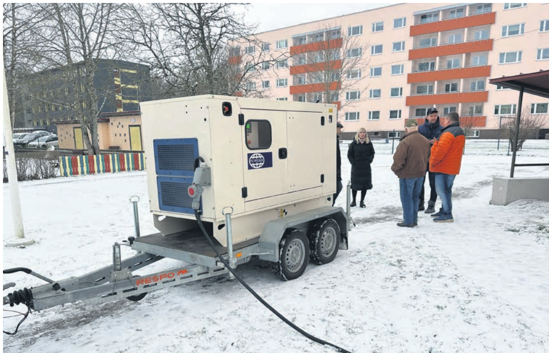
6. detsembril katsetati Sindi lasteaia, kas elektrikatkestuse korral suudab generaator hoone töös hoida
