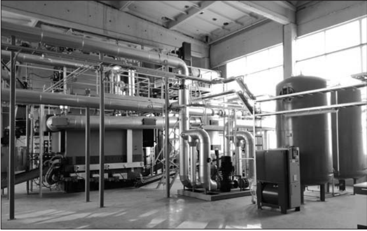
Näidis SW Energia uuest katlamajast, mis valmis 2018. aasta alguses Türil
